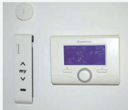
Pilot do rolet zewnętrznych, regulator pompy ciepła, wyżej czujnik temperatury.
