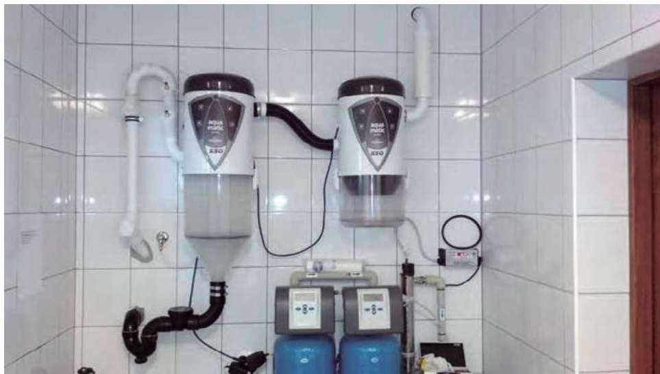
Najlepszymi miejscami na montaż jednostki centralnej są znajdujące się na parterze domu kotłownia lub garaż. ECOMAX
