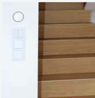
Ściemniacz i łączniki klawiszowe, na dole gniazdo ze zdalną lampką oświetlającą wejście na schody.
