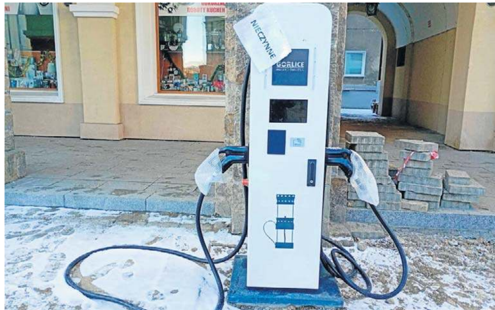
W Gorlicach są już dwie miejskie ładowarki. Na ich uruchomienie trzeba jeszcze trochę poczekać. Uporządkować rozgrzebane płytki należałoby natychmiast!
