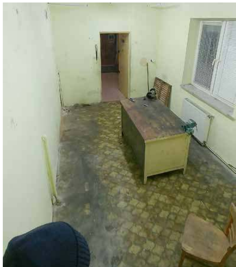
Pomieszczenie doczeka się remontu
