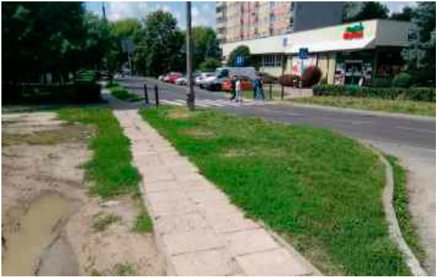
Po naszej interwencji w Zarządzie Dróg i Mostów urzędnicy sprawdzili to miejsce i obiecali szybką naprawę
