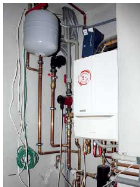
Kotłownia z kotłem gazowym – za kilkanaście lat do zobaczenia w muzeum? J. WERNER
