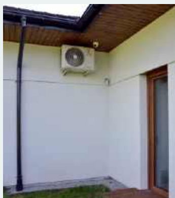
❶ Jednostkę zewnętrzną typu split zamontowano w zacienionym miejscu.
