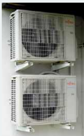
➊ Jednostki zewnętrzne zawieszono na północnej ścianie.
