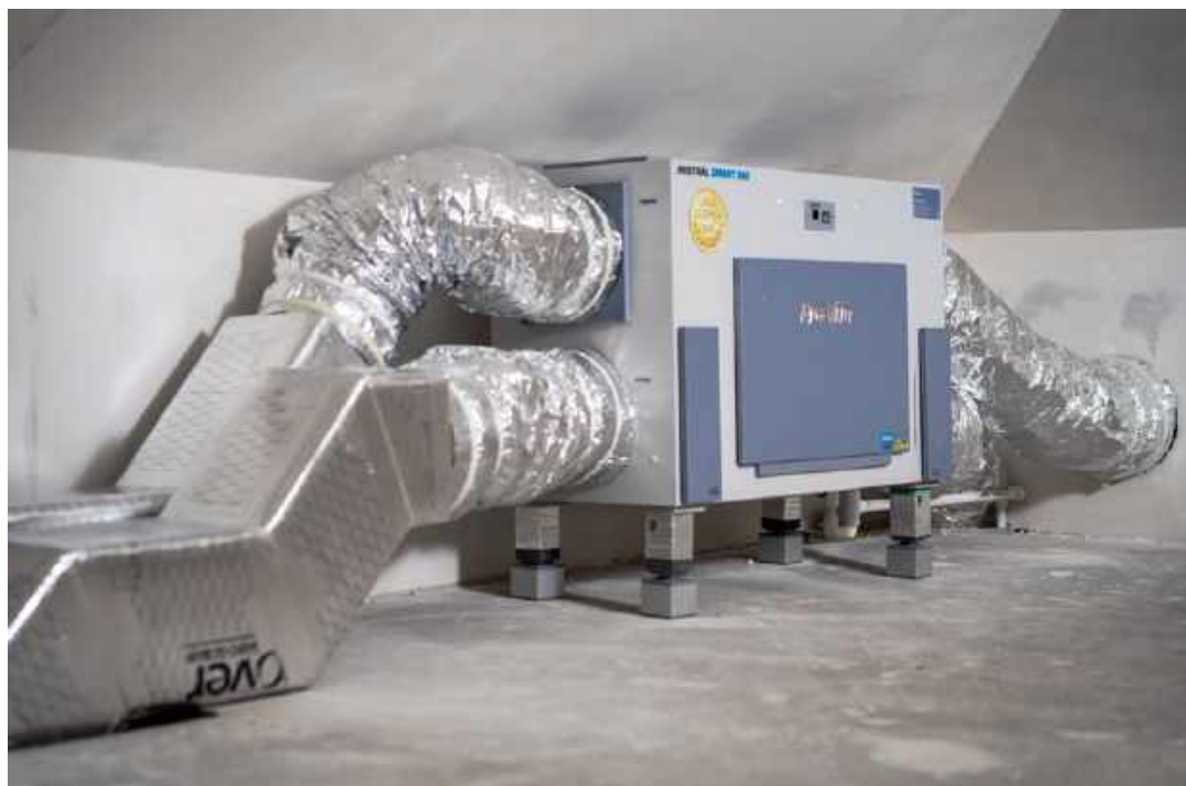
🔧 Rekuperator ustawiono na antywibracyjnych podkładkach, zaś początkowe odcinki kanałów wykonano z przewodów elastycznych. To ogranicza przenoszenie drgań i hałasu. PRO-VENT
