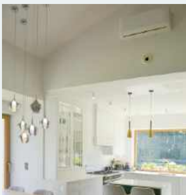
❷ Ściennej jednostki wewnętrznej wisi w wysokiej jadalni.
