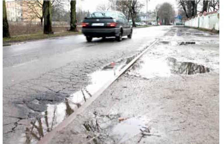
Droga na ul. Głównej. Na jezdni są spore dziury
