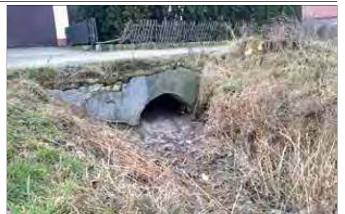
Przejazd przez przepust jest niebezpieczny.
