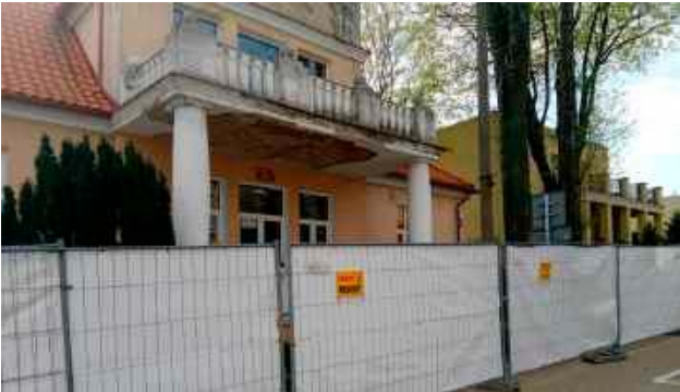
Z sufitu przedszkolnego ganku opada tynk, a i elewacja całego budynku wymaga odświeżenia
