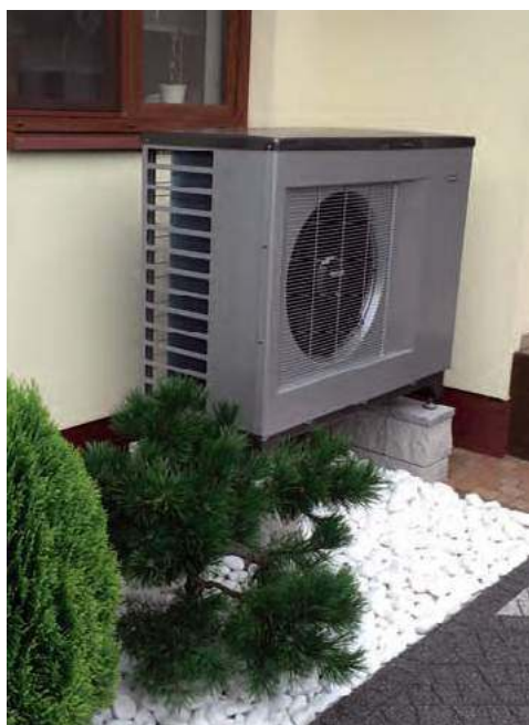
▲ Instalację fotowoltaiczną warto montować w domach, które ogrzewa zasilana prądem pompa ciepła. NIBE-BIAWAR
