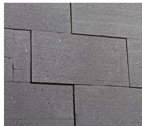
🟢 Jeżeli szczeliny powstały po przyklejeniu płyt, a one same zaczęły odstawać to znaczy, że klej już ich nie trzyma właściwie. Trzeba je zerwać i przykleić od nowa. ARCHIWUM PAWEŁ KRAUSE
