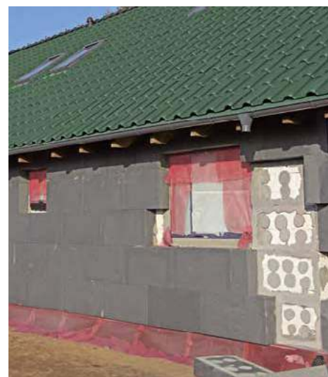
📌 Nawet prawidłowo przyklejone płyty z szarego styropianu odpadną, jeżeli narazimy je na przegzanie. ARCHIWUM PAWEŁ KRAUSE
