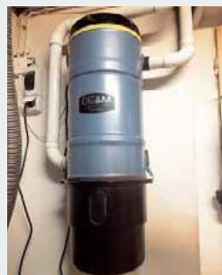
Jednostka centralna wisi w piwnicy.
