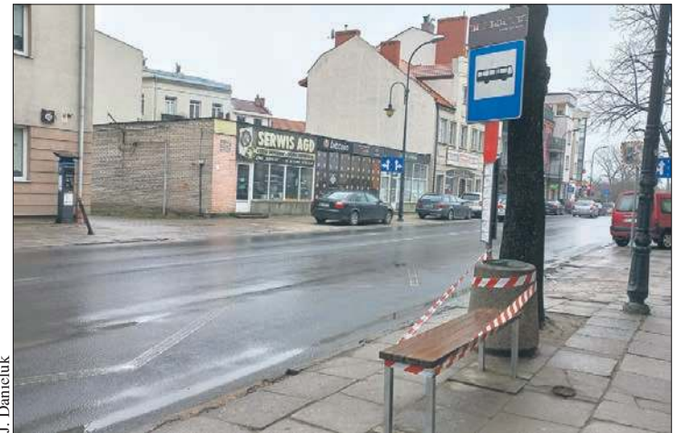
Przystanek autobusowy przy ul. Sienkiewicza 46. Na razie dla wygody pasażerów została zamontowana ławeczka. Na wiatę trzeba jeszcze poczekać
