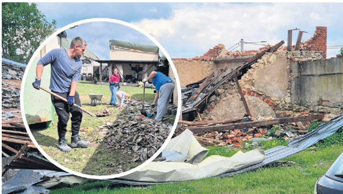
Żywioł uszkodził 38 budynków, z czego prawie co trzeci to dom mieszkalny.
