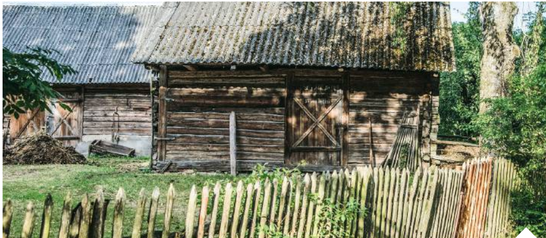
Polska nie ma szans na dotrzymanie terminu oczyszczenia kraju z azbestu | fot. Andrzej Sidor/Forum
