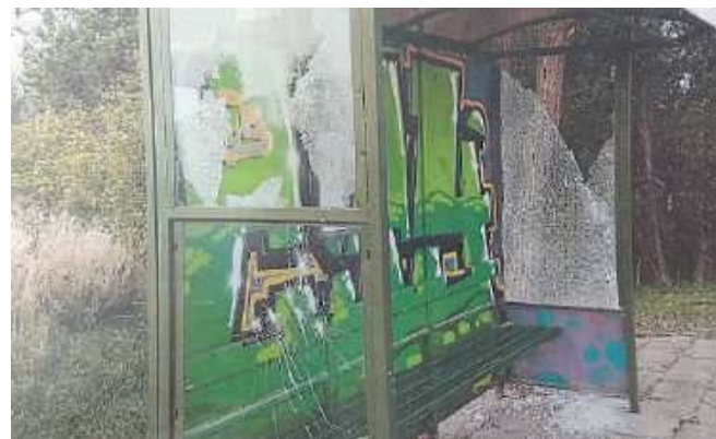
Wandale zdewastowali wiatę za pomocą młotka bezpieczeństwa
