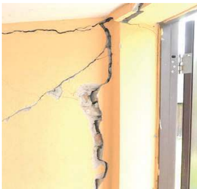
Siła eksplozji spowodowała uszkodzenie pomieszczenia w budynku, w którym znajdowała się letnia kuchnia
