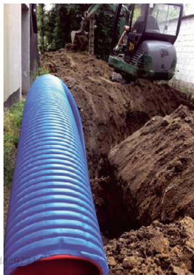
Gruntowy wymiennik ciepła montuje się poniżej poziomu przemarzania gruntu. WENT-DOM
