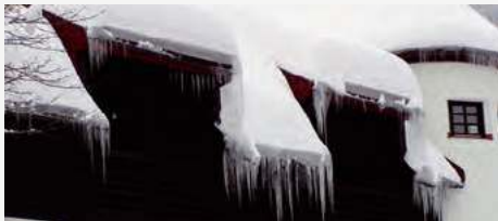
❗ Brak instalacji przeciwooblodzeniowej wiąże się z ryzykiem, że gromadzący się na dachu śnieg i lód zerwie orywnowanie. T. RYBARCZYK
