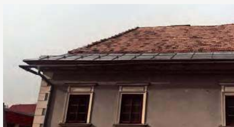
❗ Nieprawidłowo zamontowana rynna spowoduje zalewanie elewacji wodą opadową. T. RYBARCZYK
