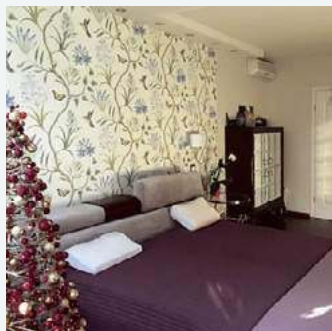
➤ Jednostkę wewnętrzną celowo powieszono daleko od łóżka.
