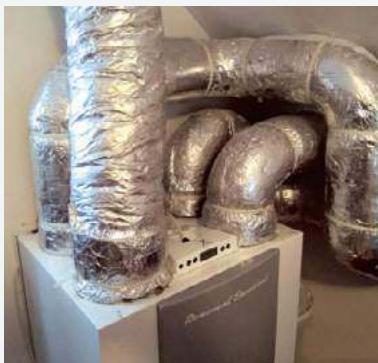
Zaizolowane przewody wentylacyjne i regulator na obudowie centrali.
