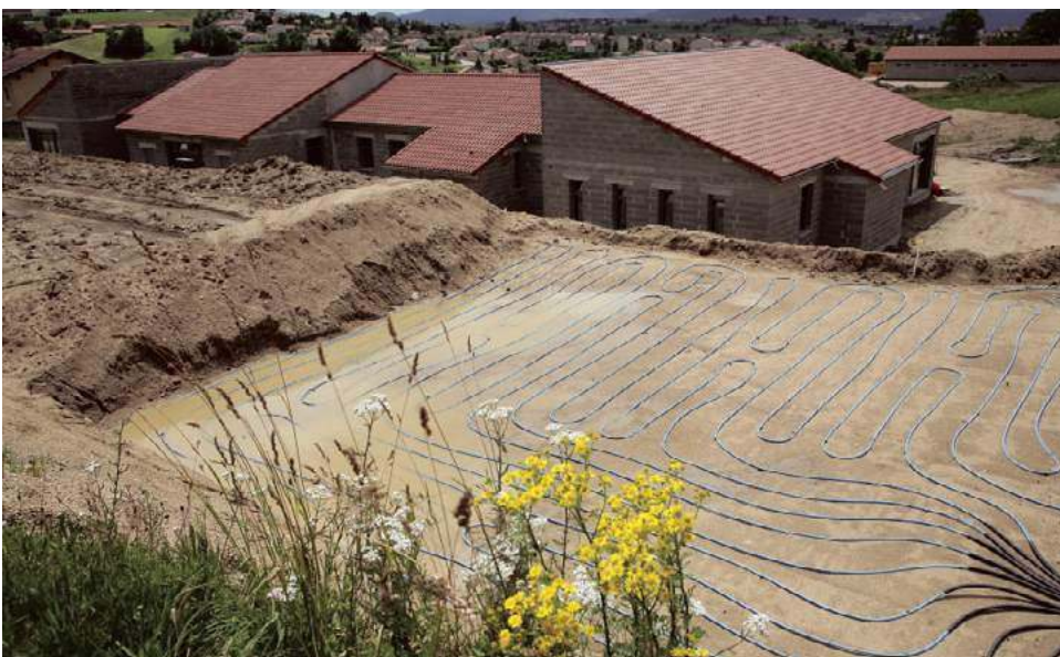
📍 Temperatura gruntu pozostaje mniej więcej stała przez cały sezon grzewczy. Stwarza to bardzo dobre warunki pracy pompy ciepła i przekłada się na niższe rachunki. DE DIETRICH (SOFATH)
