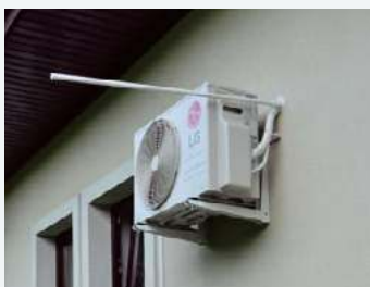
📍 Jednostkę zewnętrzną ulokowano pod oknem.
