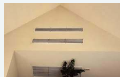
Najniżej położona kratka kończy kanał nawiewny w salonie, kratki wyżej dotyczą instalacji klimatyzacyjnej.
