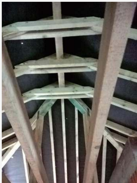
⚠ Uszkodzenie poszycia będzie skutkowało zaciekaniami. T. RYBARCZYK
