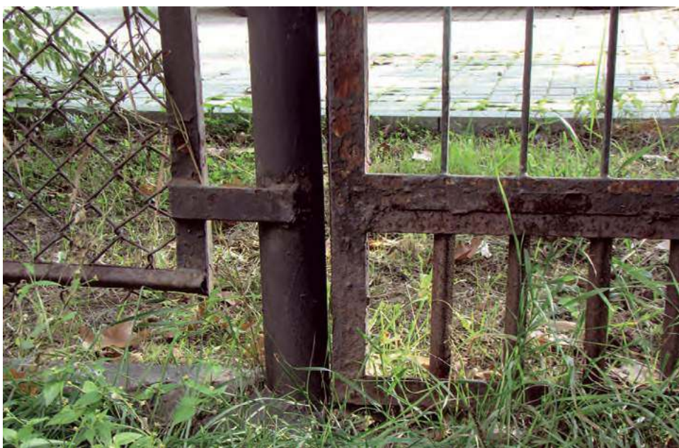
🔧 Ogrodzenie metalowe w takim stanie można spróbować wyczyścić i pomalować. Ale poniesiemy koszty, a efekt i tak nie będzie zadowalający. ARCHIWUM BD
