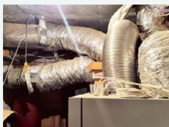
Centrala wentylacyjna z obrotowym wymiennikiem ciepła wisi w kotłowni na parterze.
