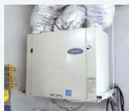
Centralę wentylacyjną zawieszono w kotłowni.
