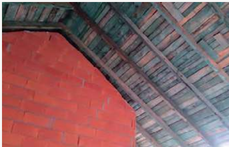
🔧 Jeden z częściej spotykanych błędów przy wykonywaniu więźby – brak płatwi podtrzymujących długie krokiewie. T. RYBARCZYK
