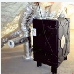
Centralę zamontowano na nieużytkowym poddaszu.
