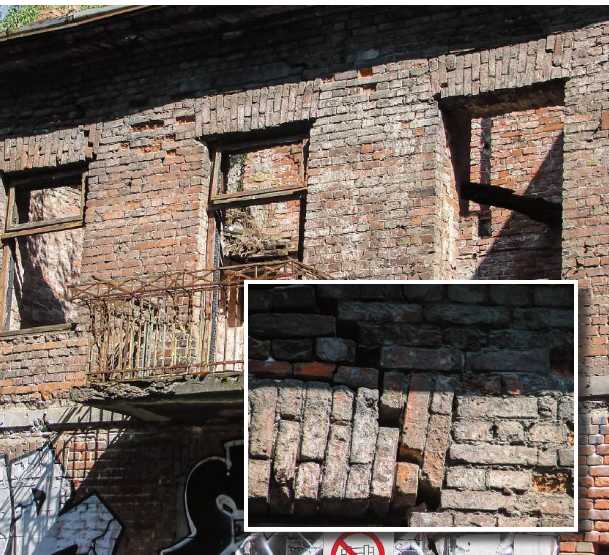
Fragment murów fasady Łuckiej 8 i przemieszczenia cegieł w nadprożach | fot. Janusz Sujewski/Gazeta Polska
