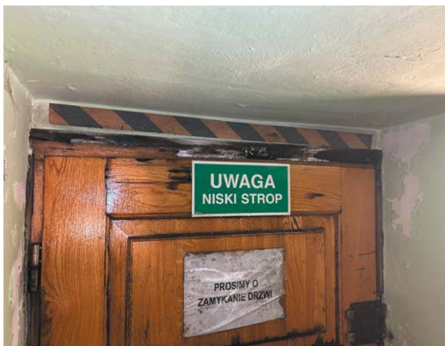
FOT. 1 Nieprawidłowo ocieplone (przemarzające) drewniane drzwi zewnętrzne zaatakowane przez grzyba w wyniku zawilgocenia powstałego na skutek kondensacji pary wodnej; fot.: autor
