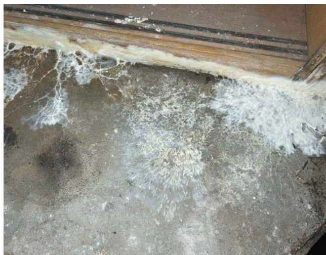
FOT. 2 Grzyb domowy rozwinął się w zawilgoconej piwnicy, w której przechowywano drewniany regał; fot.: autor
