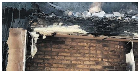
FOT. 1 Nieskuteczne nadproże z wełny mineralnej; fot.: M. Niziurska, B. Chruściel, M. Wieczorek
