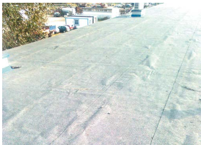
FOT. 2 W warstwach termoizolacji starego pokrycia może znajdować się wilgoć. Przykrycie takiego dachu szczelną warstwą hydroizolacji doprowadzi do powstania pęcherzy powietrza, co zniszczy nową powłokę.
