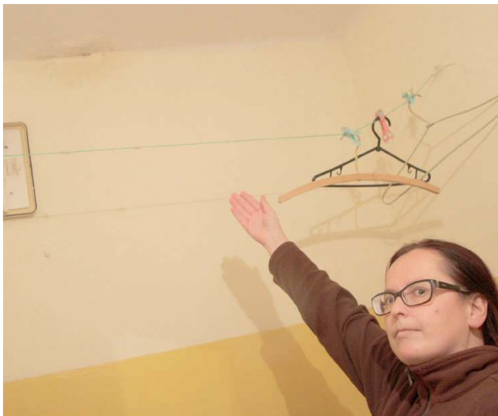
Na suficie w łazience wyraźnie widać plamę wilgoci
