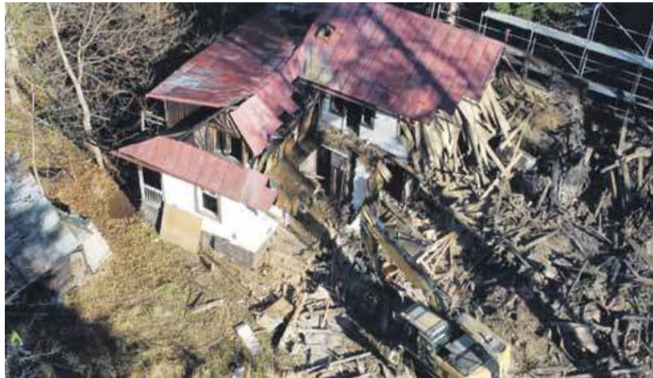
Rozbiórka Chaty ruszyła, zdaniem konserwatora zabytków w tym miejscu powinna zostać odtworzona pierwotna zabudowa
