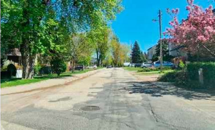
Ulica Wiejska nie może doczekać się obiecanego remontu
