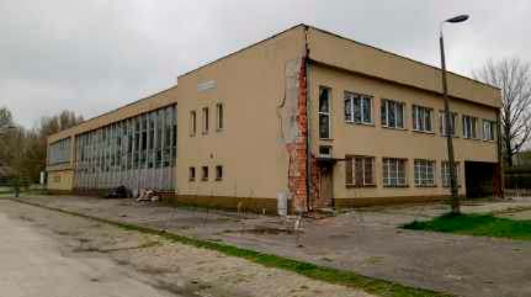
Budynek dworca północnego przedstawia obraz nędzy i rozpacz
