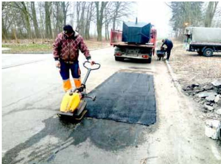
Wiosna to dobry czas na przeprowadzenie napraw na jezdniach i uzupełnienie ubytków
