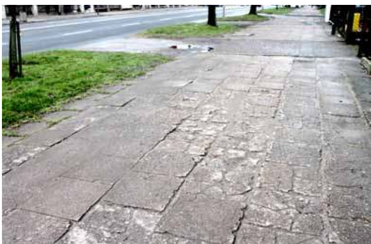
Chodnik na Szczecińskiej, na odcinku od Poczty w stronę stacji paliw, jest miejscami w złym stanie
