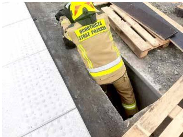
Strażacy uratowali borsuka, który wpadł do studzienki teletechnicznej. Foto OSP Dobrzany
