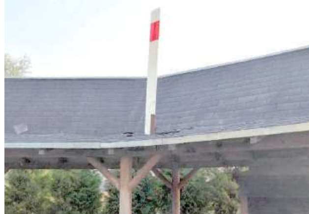
POWIAT ŁUKOWSKI W Dębownicy, w gminie Trzebieszów wandal wyrwali z drogi słupki i wbili go w dach gminnej altanki (fot. Gmina Trzebieszów)
