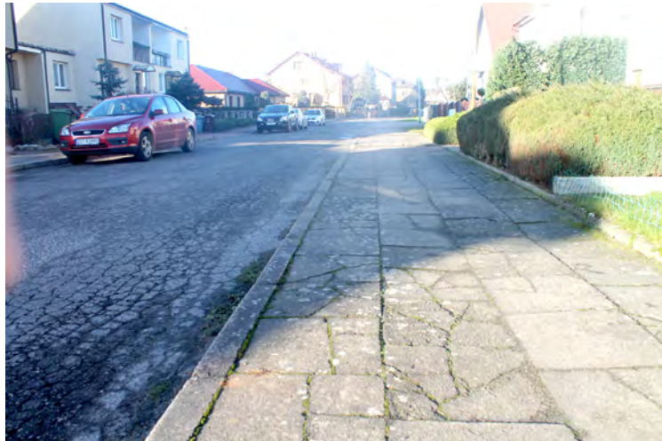
Poprawy wymagałyby również estetyka chodnika
