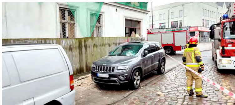
Przy ulicy Chrobrego elewacja z budynku przeznaczonego do rozbiórki spadła na zaparkowany w pobliżu samochód. Foto PSP Stargard
