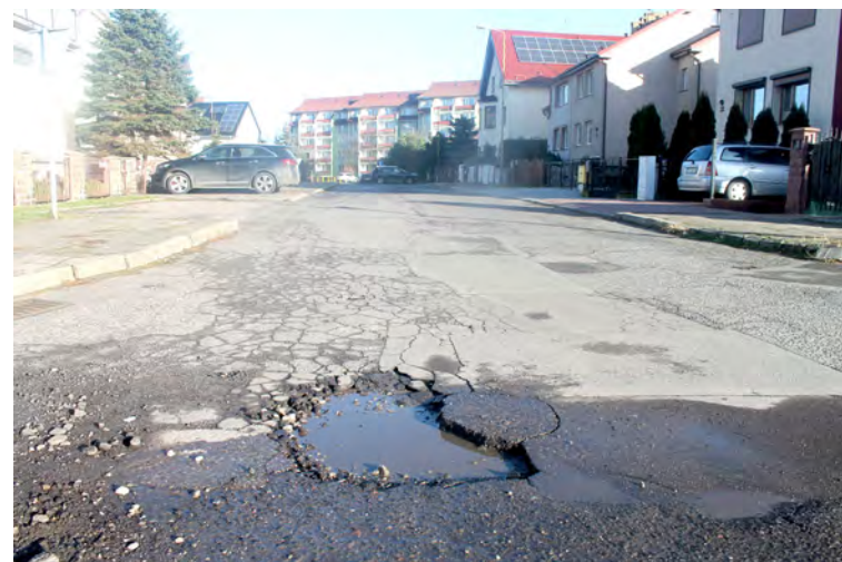
Spora dziura "wita" kierowców już przy wjeździe na drogę na Kasprowicza.
