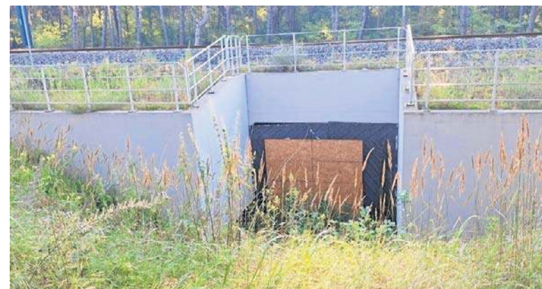
Tunel pod linią kolejową Toruń-Chełmża, obok przystanku Toruń Katarzynka, jest zabity płytami pilśniowymi
