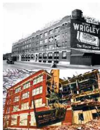
W 2013 roku w Chicago przeprowadzono rozbiórkę budynku dawnej fabryki gumy do żucia Wrigley (z 1911 roku).
