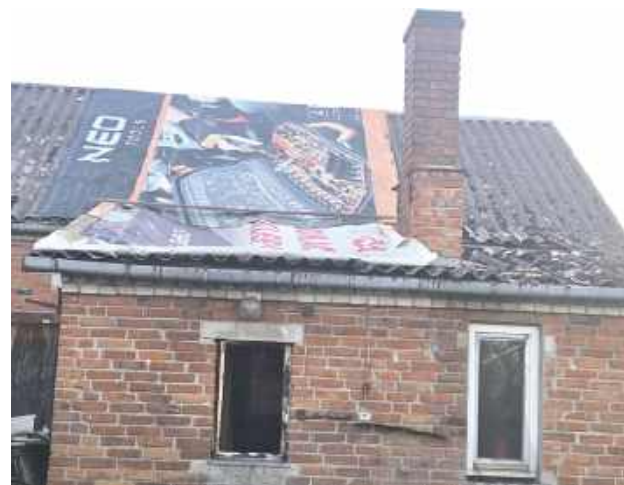
Po pożarze do wymiany jest cały dach z eternitu, który uszkodził się wraz z krokiewiami. Ucierpiała też łazienka, korytarz i kotłownia.
