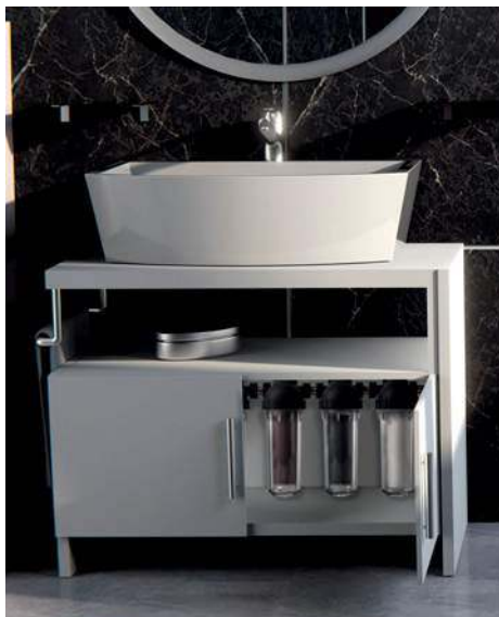
🔧 Filtry przepływowe umieszczone w szafce pod umywalką. DAFI (FORMASTER)
