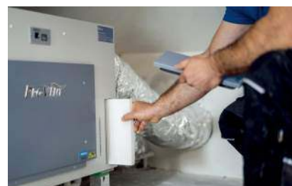
Wymiana filtra w rekuperatorze. PRO-VENT
