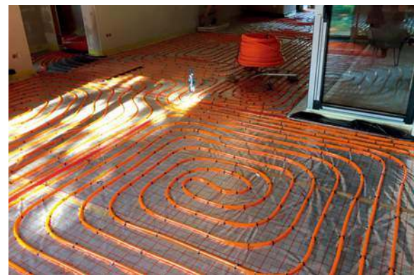
Im niższa temperatura wody w instalacji, tym lepiej pracuje pompa. Dlatego najlepiej sprawdza się w duecie z ogrzewaniem płaszczynowym – podłogowym, sufitowym lub ściennym. RWC (JOHN GUEST)
