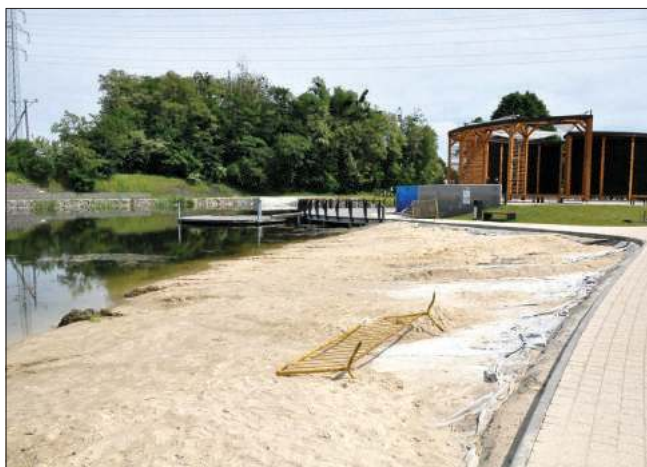
Nowa plaża została zniszczona w trakcie majowej ulewy
