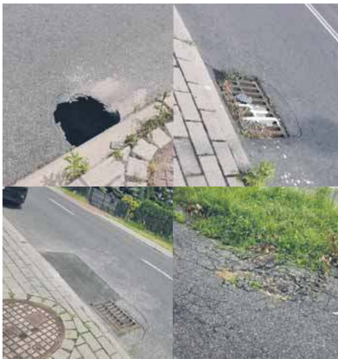
Uszkodzenia w infrastrukturze
