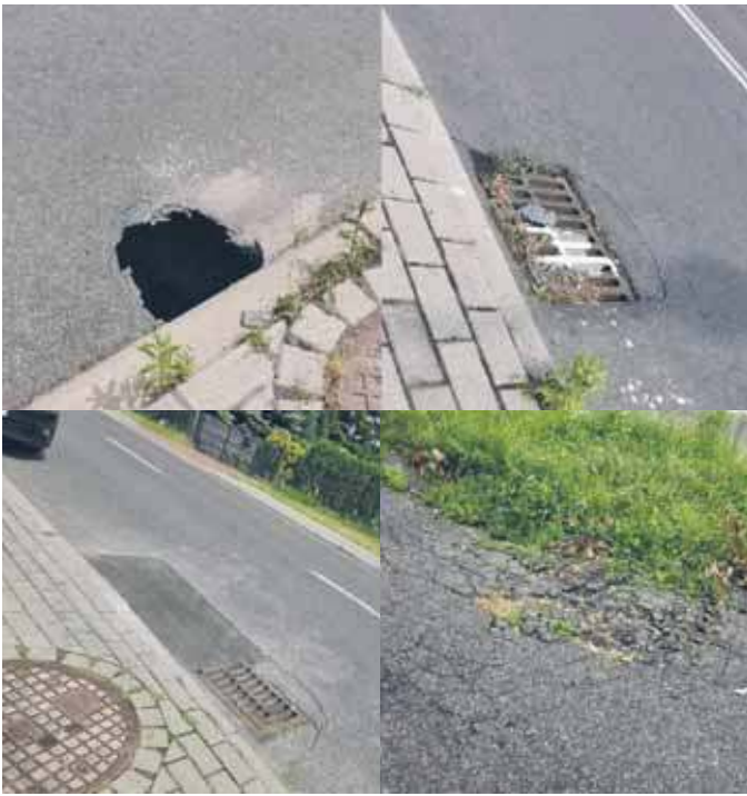
Uszkodzenia w infrastrukturze
