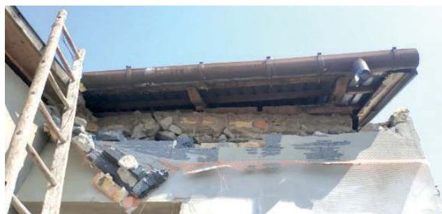
Budynek jest niezdolny do zamieszkania, ma naruszoną konstrukcję dachową
