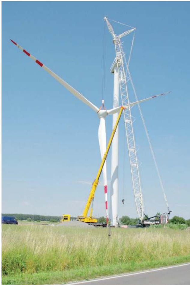
Podczas montażu elektrowni wiatrowych nie było na placu budowy inspektora nadzoru inwestorskiego
