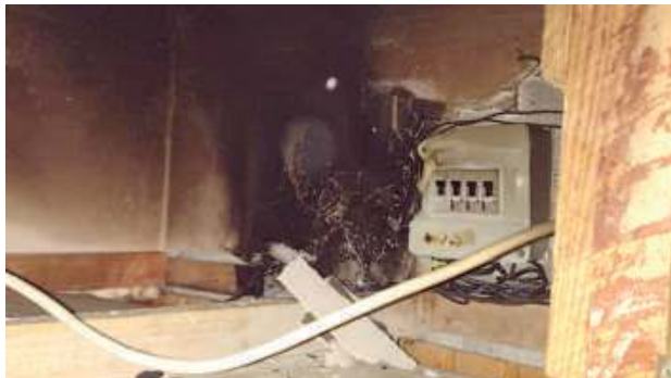
mo Do pożaru doszło z powodu zwarcia instalacji elektrycznej (fot.KP PSP Łuków)
