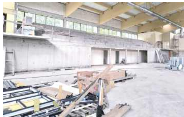
Celem wizytacji było zapoznanie się ze stanem zaawansowania prowadzonych prac oraz omówienie planowanych działań inwestycyjnych
