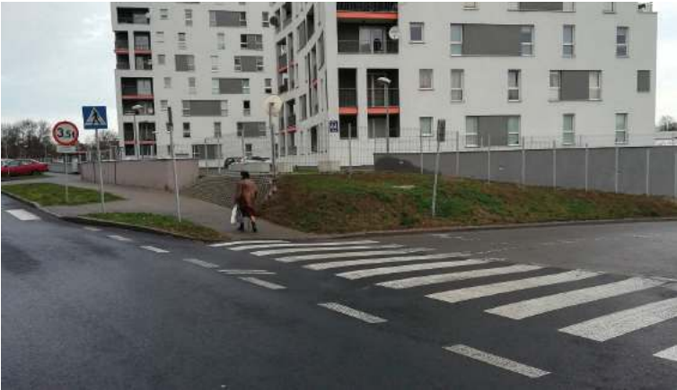
Zdjęcie „splaszczło” problem, ale faktycznie zagłębienie ma już około 30 centymetrów i przy szybszej jeździe naprawę można uszkodzić samochód
