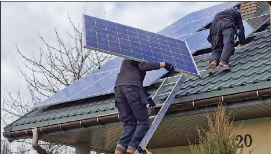
W ramach klastra energii zostanie zainstalowanych m.in. 907 nowych instalacji fotowoltaicznych na terenie gminy Ryki, Kłoczew i Nowodwór
