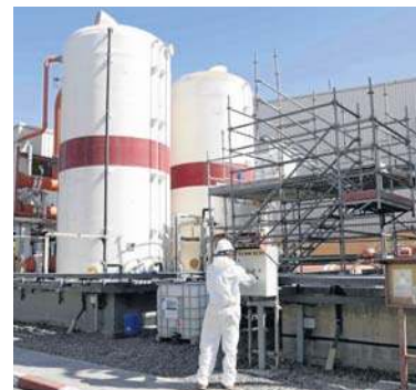
Instalacje odsalania wody morskiej mają strategiczne znaczenie w Zatoce Perskiej
