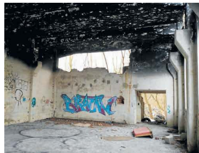
Buszowanie po tym terenie może być naprawdę niebezpieczne. Obiekty grożą zawaleniem
