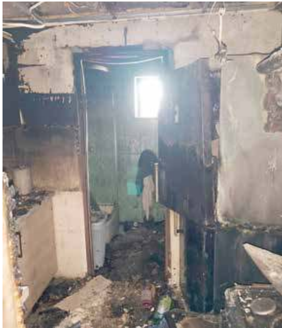
Mieszkanie zostało zniszczone
