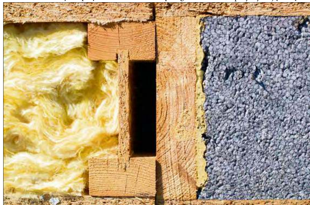
Ważne jest dokładne sprawdzenie stanu izolacji w domu.
