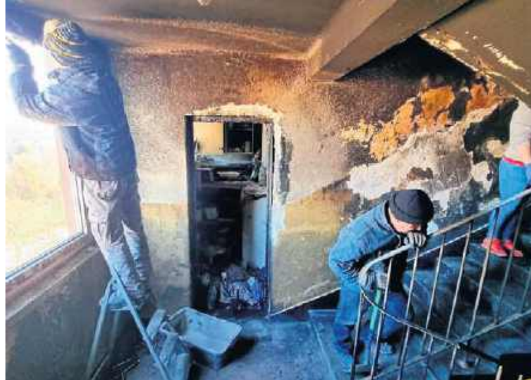
Tak po pożarze wyglądała klatka w bloku przy Karłowicza w Kielcach
