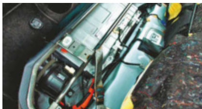
AKUMULATOR trakcyjny oraz rozruchowy 12 V są zamontowane pod kanapą.
