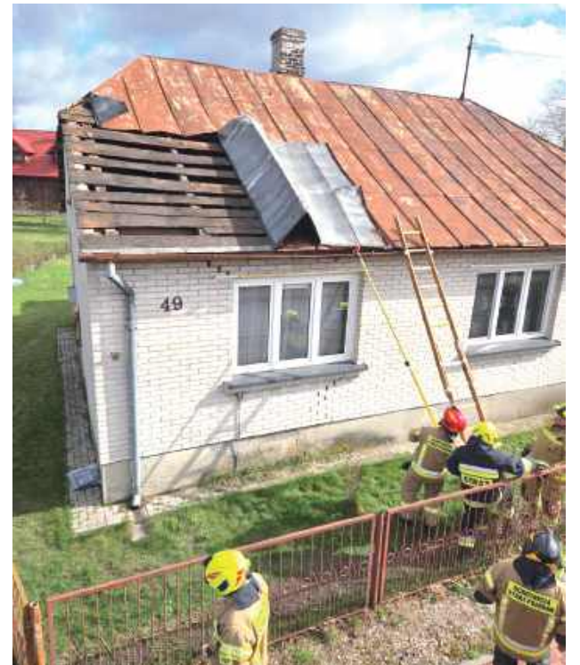
6 kwietnia ochotnicy ze Stężycy zostali zadysponowani do zerwanego dachu na jednym z domów w miejscowości Stężycy. Działania trwały 2 godziny
