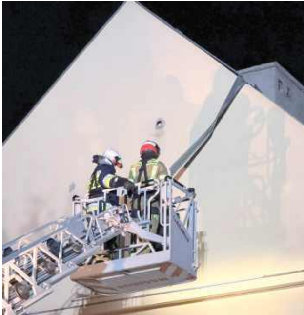
Strażacy przy pomocy drabiny dostali się do blachy i ją zabezpieczyli, aby nie spadła i nie zrobiła komuś krzywdy
