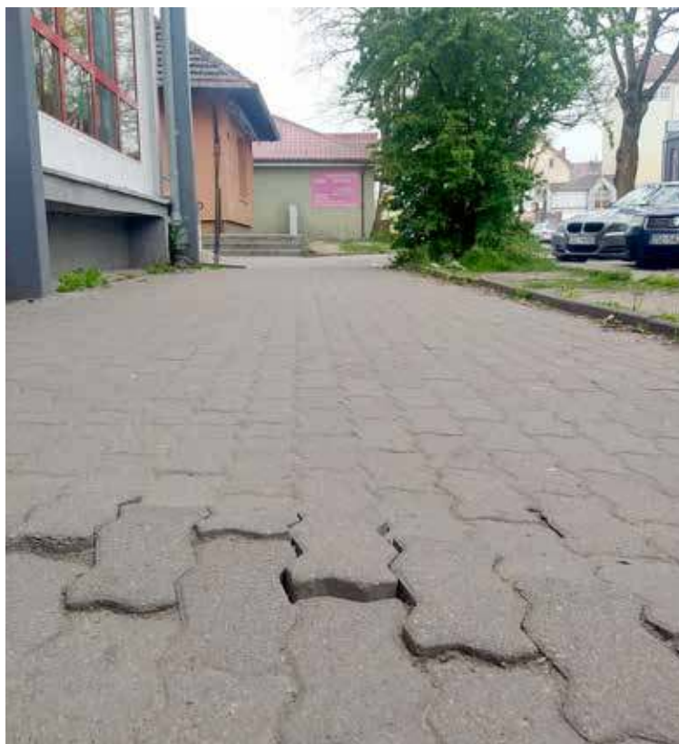
Wystające ponad poziom fragmenty kostki okazują się przeszkodą podczas chwili nieuwagi
