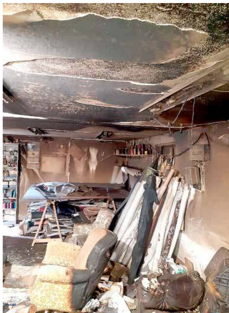
Pomieszczenie w budynku RCP, gdzie znajdował się warsztat spłonęło do szczętnie
