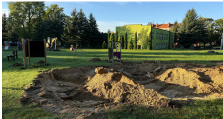
Aktywny plac zabaw przy Żłobku Miejskim nr 1 w Brzegu Dolnym – przystąpiono do prac demontażowych oraz niwelacyjnych.
