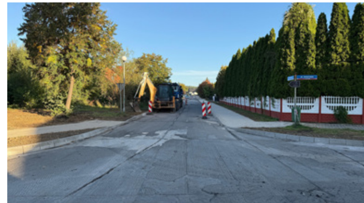
Remont ul. Wierzbowej w ramach zadania pn. Przebudowa ul. Wierzbowej w Brzegu Dolnym.
