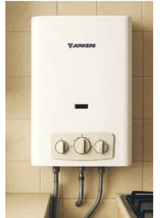
Bierze wodę, przyska nią pod junkers, robi się płama, potem zdejmuję obudowę kuchenki i mówię, że piec cieknie
