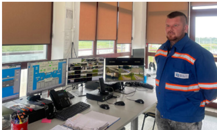
Obiekt monitorowany jest całą dobę przez pracowników.
