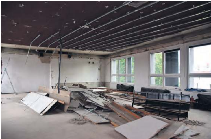
Piotr Mówiński przy okazji kolejnego remontu w TOK-u korzysta z prywatnego doświadczenia, jeśli chodzi o nowoczesne źródła ciepła.
