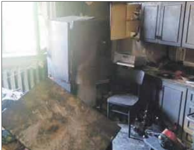
Część pomieszczeń w domu nadaje się do generalnego remontu
