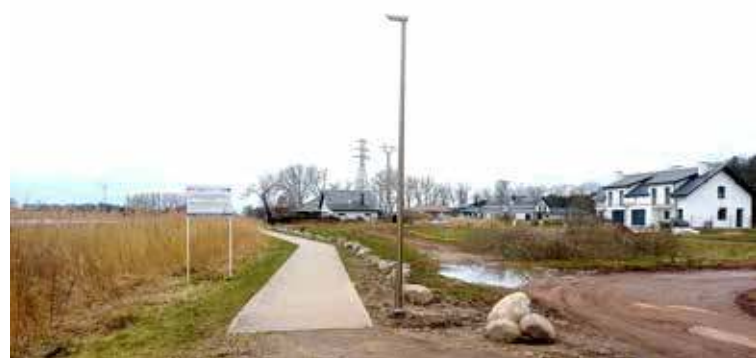
Jedna z zamontowanych lamp na początku roku widoczna od strony ul. Promenady
