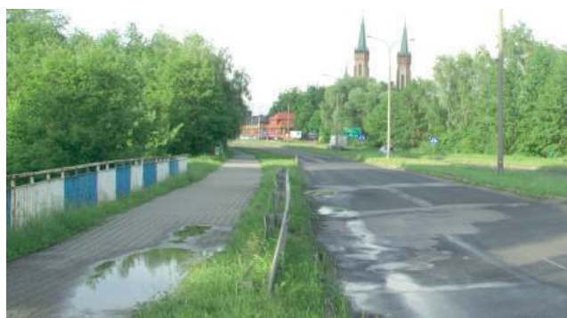
Przeznaczony do remontu odcinek al. Jana Pawła II, to jedna z najgorszych nawierzchni na terenie Parczewa
